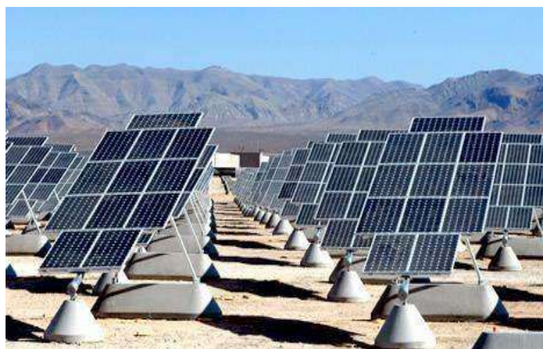
Gambar 2.4 Pembangkit listrik tenaga surya (PLTS) [3]
